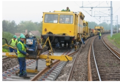
Longs Rails soudés sur traverses béton
